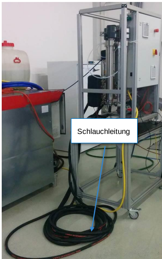
Abb. 59: Schlauchleitungen, Quelle: Eigene Darstellung.
